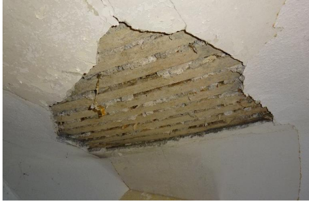
Deckenkonstruktion sichtbar, vermutlich durch Feuchtigkeit aus dem Dach
