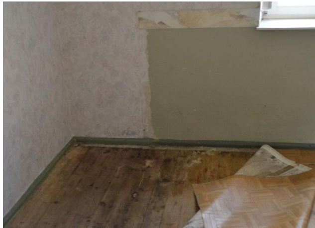
Raum 1 Schimmelpilzbefall der Bodendielen
