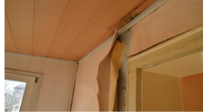
Decke im Holzanbau im 1. OG, Wasserschaden und Schimmelpilzbefall, vermutlich ist das Dach undicht
