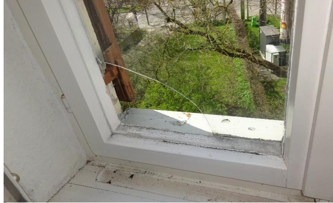
Fensterscheibe auf der Westseite Raum 8 zerbrochen
