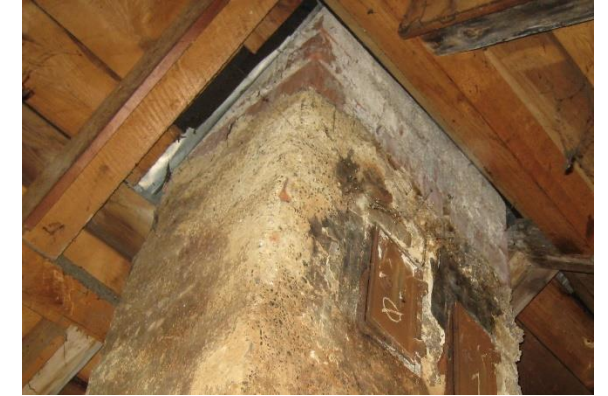
Kaminverwahrung undicht, Wasser läuft den Kamin und die Sparren entlang nach unten
