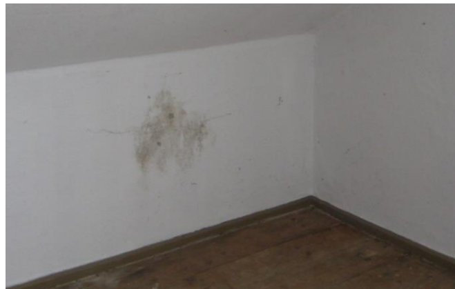
Feuchteschaden im Bereich der gebrochenen Traufe auf der Südseite des Hauses
