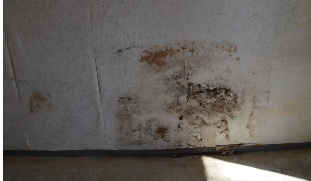
Raum 2 Außenwand Ost Schimmelpilzbefall
