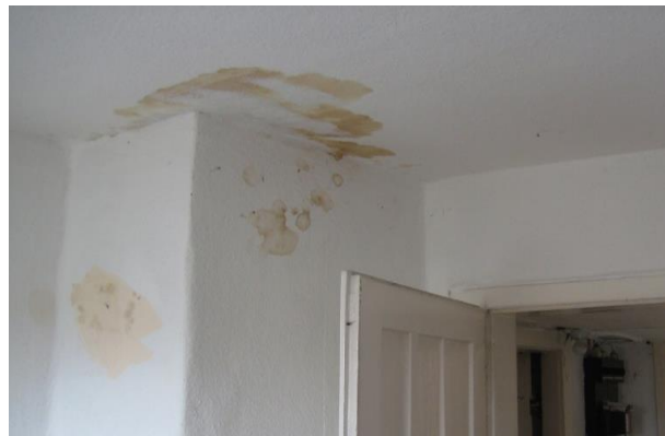
Feuchteschaden im Bereich des Kamin Durchbruches
