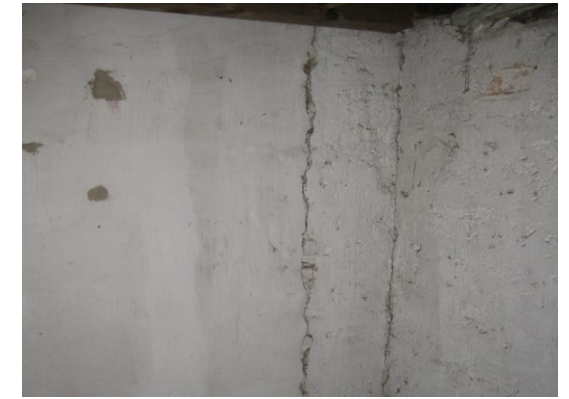
Risse über die komplette Wand
