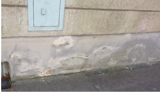
Sockelputzabplatzungen, um das komplette Gebäude ist der Sockelputz beschädigt
