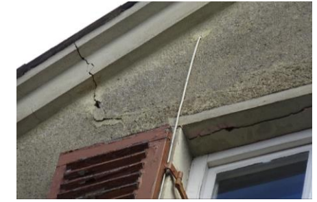
Risse in der Fassade und dem Fenstersturz
