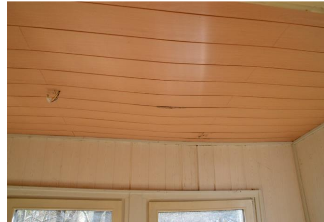
Die Decke neigt sich nach unten
