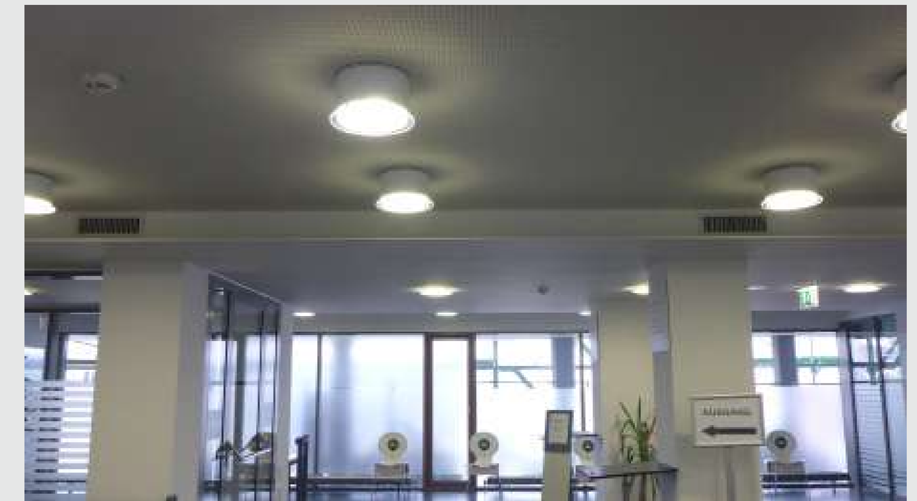
Detail: Eingangsbereich Bürgerbüro Energiesparlampen Abluft
