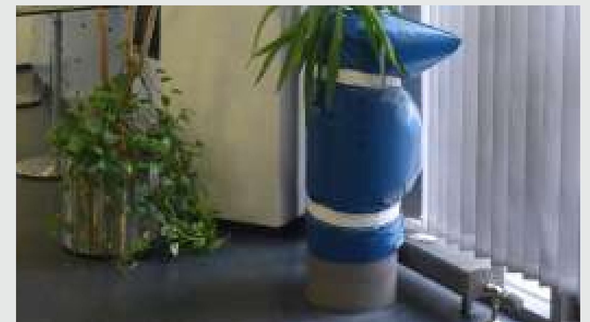
Detail: Eingangsbereich Bürgerbüro - Luftauslass abgedeckt
