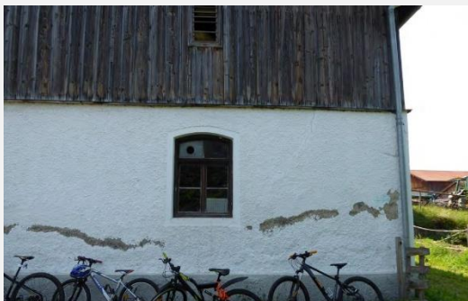
Abbildung 45: Risse in der Außenwand, Nord
