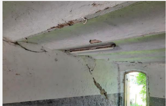
Abbildung 44: Risse bei Kappenträger
