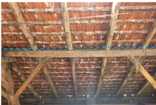
Abbildung 41: starke Durchbiegung der Pfetten
