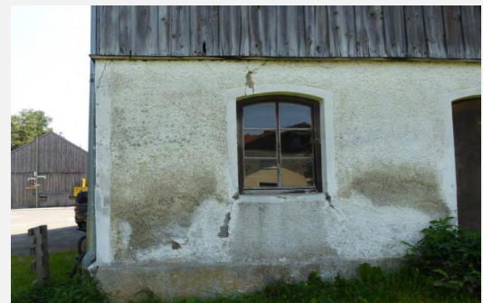
Abbildung 46: Risse in der Außenwand, West
